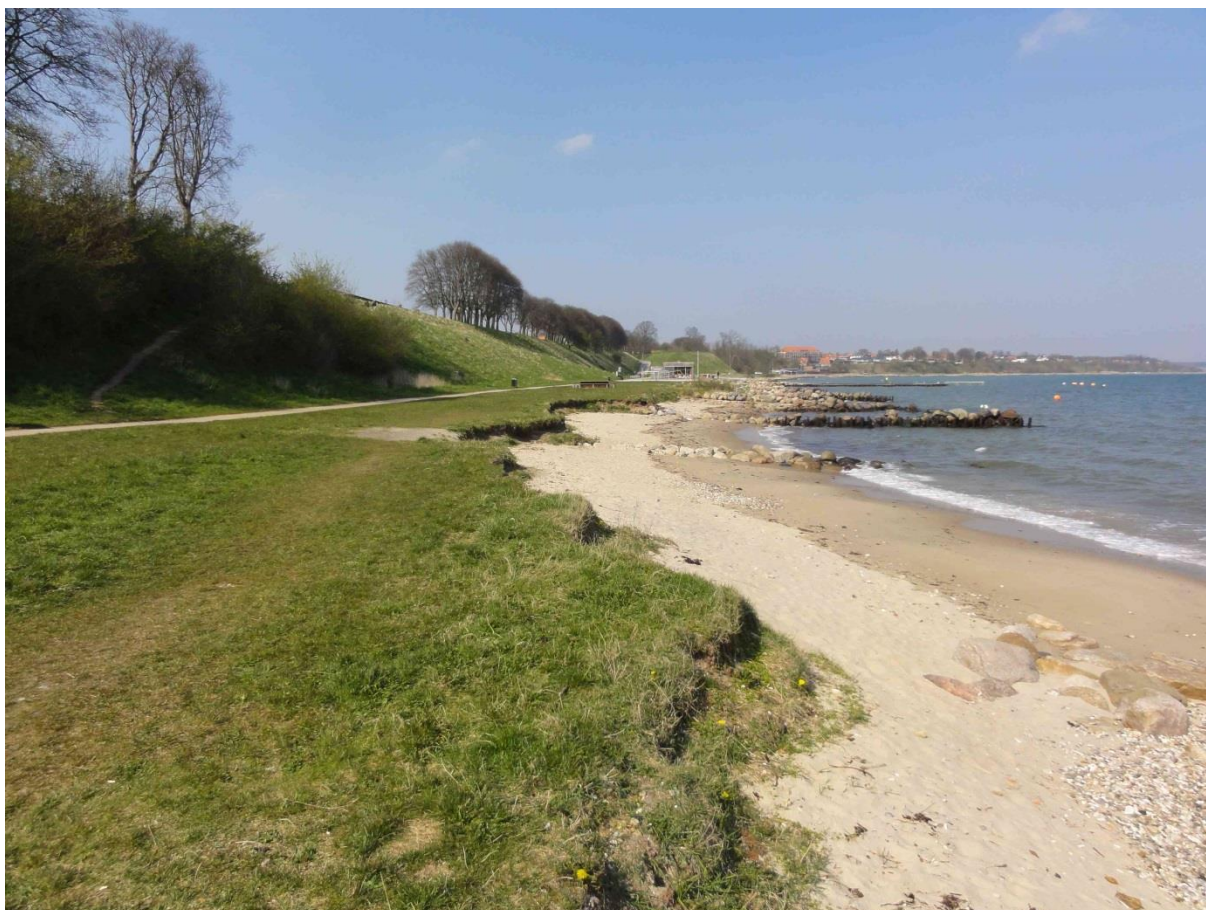
Figur 8 Skader på græsareal ved foden af Volden, foto af Lars K. Bak..
