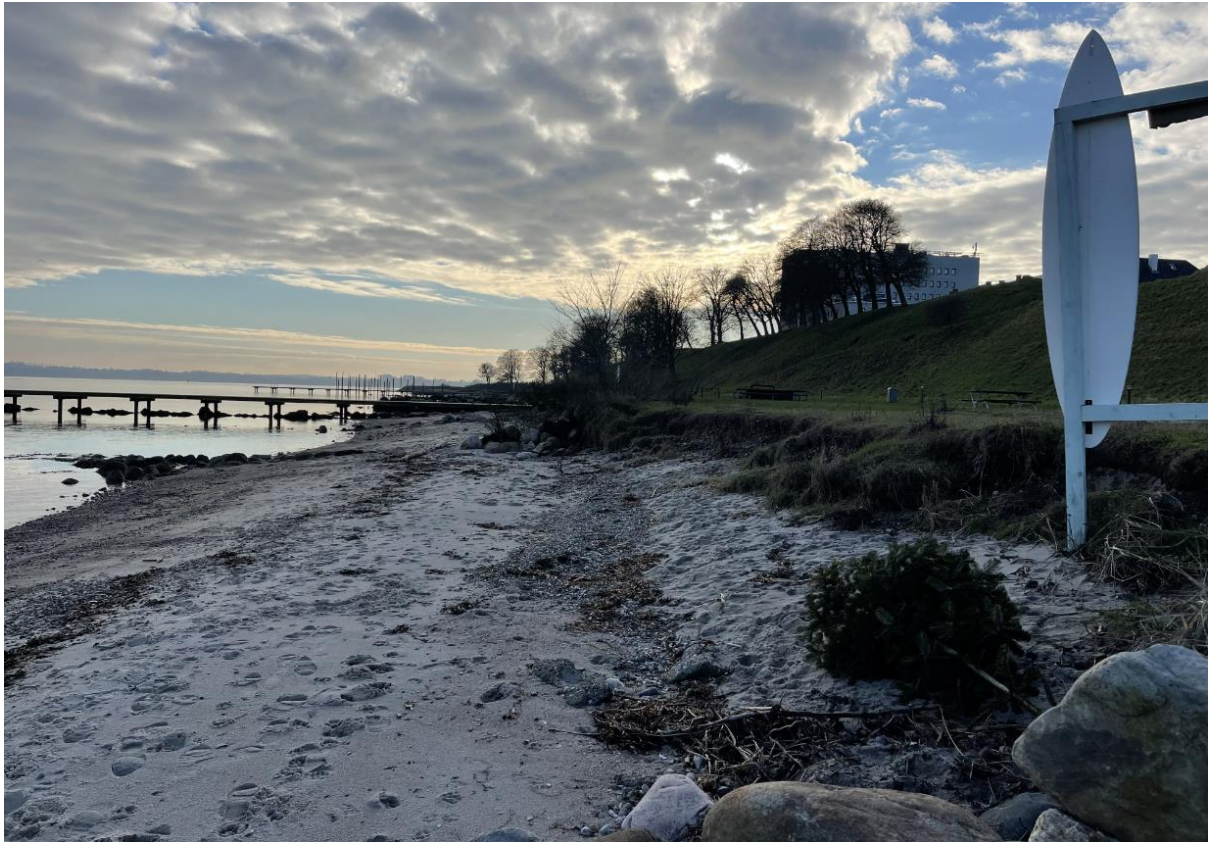
Figur 2-11 Erosion af bagstrand syd for skråningsbeskyttelsen og Cirkelbroen, 25.01.2023
