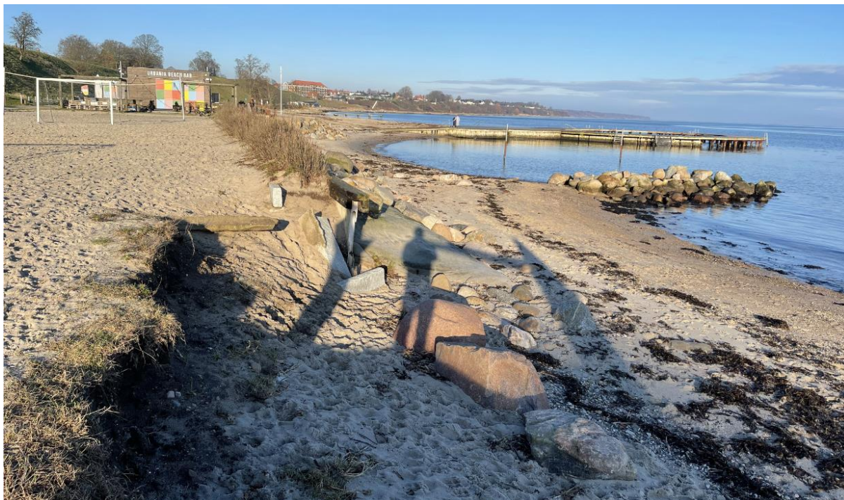
Figur 2-9 Skader på skråningsbeskyttelse og stranden syd for Cirkelbroen, 25.01.2023
