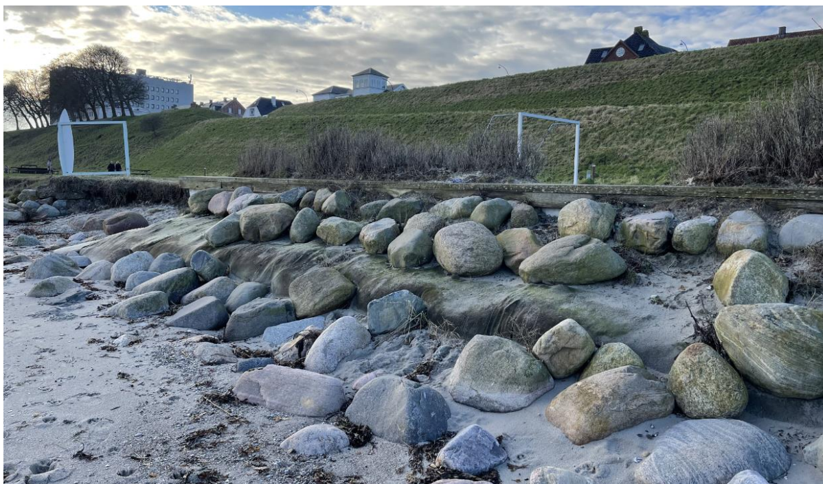
Figur 2-8 Skader på skråningsbeskyttelse ved Østerstrand, 25.01.2023
