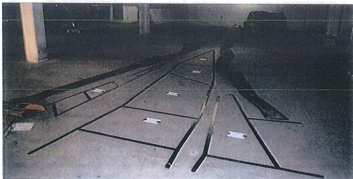
Figur 15 Indsamlede pladestykker oplagt således, at de visualiserer revneforløbet og samtidig giver mulighed for systematisk at inspicere det samlede revneforløb.
