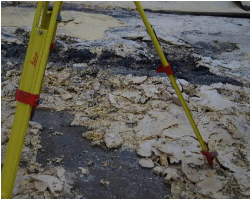
Figur 4.5 PFAD/CPO ovenpå asfaltbelægning ved tankområdet den 6. februar 2016. Foto: DMR A/S.
