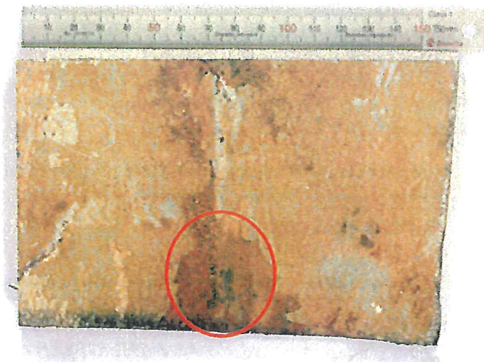
Figur 30 Udsnit af pladestykke 2 med svejsning mellem Rand 5 og 6 set fra udvendig side. Bemærk afskalning af maling og korrosion omkring reparations-svejsningen, som er markeret.
