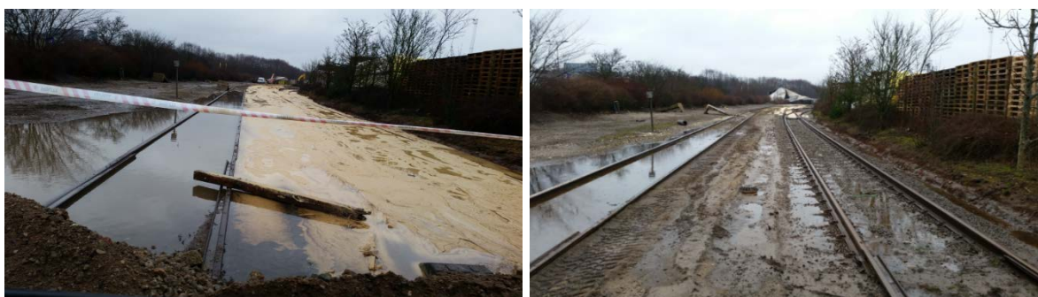
Figur 4.9 og 4.10 Banelegemet langs med og sydøst for Strandvejen. Billederne er taget samme sted og mod NV fra Nyhavnvej.
