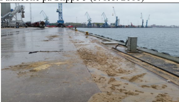
Kajkanten på Oeankajen. Der er ingen opkant til tilbageholdelse af større mængder spild. (5. feb. 2016)
