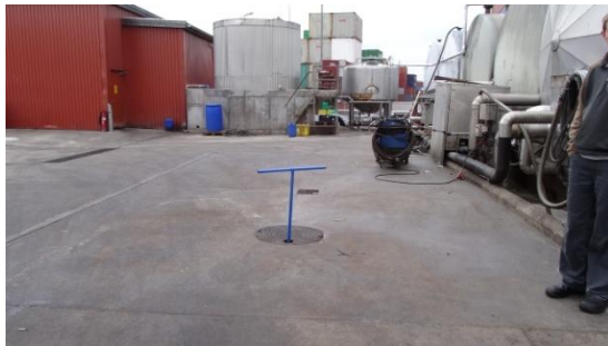
Figur 4: Afspærringsventil før olieudskiller i forbindelse med vaskeplads
