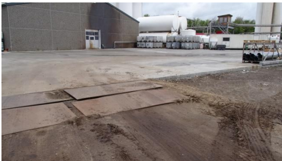
Figur 2: Manglende opkant ved administrationsbygning, Møllebugtvej 9
