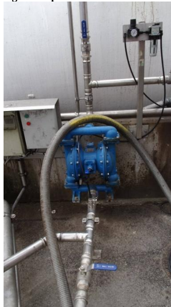
Figur 8: Pumpe til fjernelse af regnvand og spild fra tankgårde
