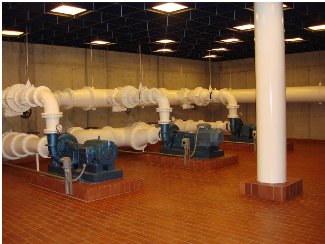
Udpumpningsanlæg på TRE-FOR Vand Tørskind Vork Vandværk (Foto: Fredericia Kommune)
