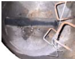
Tætte og vedligeholdte kloakker er den bedste form for rottesikring. Foto: Peter Weile
